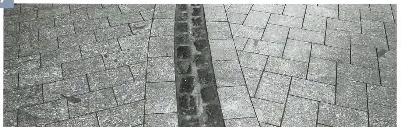
Die hellen Granitplatten aus dem Süden Portugals sind auf dem Marktplatz im Reihenverband verlegt. Die im Ellbogenverband verlegte Straße setzt sich davon ab
