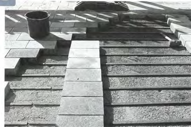
Damit sich die Schienen nicht verschieben, werden zuerst einige Platten in einer Reihe verlegt
