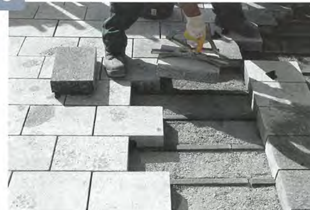
Die Steinplatten werden nun einzeln auf die Schienen gesetzt und richtig positioniert
